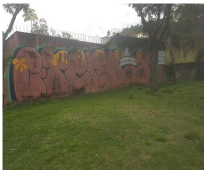
Figura 1 – Bomb , em muro de imóvel residencial, localizado na Avenida Agulhas Negras, Belo Horizonte, MG.
